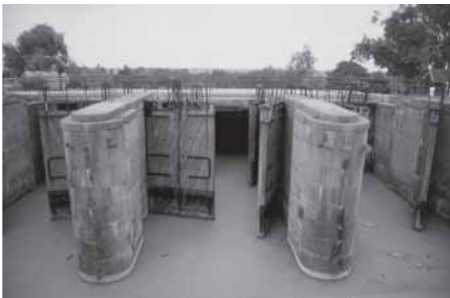
15. De Ambtssluis te Dalem vanuit het zuiden, met in de middelste kolk de drie paren puntdeuren – twee geopend, de derde gesloten (foto: A.F.J. Niemeijer, 1996).
