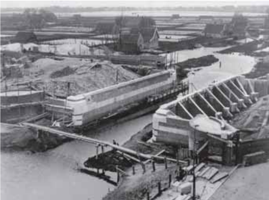
2. De stad rukt op. Brug nr. 381 over de Admiralengracht in aanbouw in Amsterdam-West, 1933. Nog ligt de brug in het landelijk gebied, sinds 1921 deel van de gemeente Amsterdam. Maar de verstedelijking was onafwendbaar, en enkele jaren later was alles verdwenen onder het ophogingszand voor de nieuwbouw (Foto: ANP).
