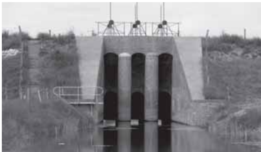
Inundatiesluis Hedikhuizen. (Foto: Waterschap Aa en Maas, 's-Hertogenbosch)
